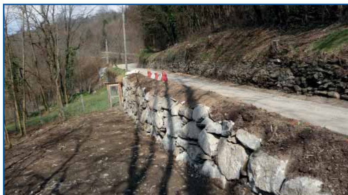
Route du Vernay (ancienne route de Mailles) : enrochement grâce à l'aimable autorisation de la famille Brunet-Manquat qui cède à la collectivité l'emprise nécessaire. Pose d'une grille de pluvial dans le virage. L'enrobé qui a été fait depuis a permis de rectifier le profil de la chaussée
