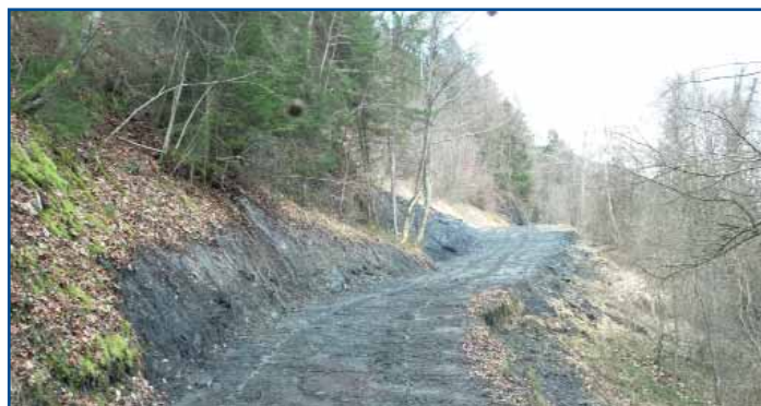
Chemin des Meures, en mars. Réparation, renforcement suite aux éboulements consécutifs à ELEANOR. Réfection des fossés et renvois d'eau. Important : dessert des propriétés boisées mais aussi le captage principal de Morêtél de Mailles.
