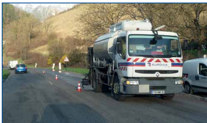
RD525 : - Elargissement pour création bande cyclable dans le sens de la montée - Réfection du tapis - Maître d'ouvrage : CD38
